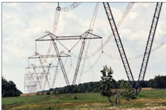
МЕЖГОСУДАРСТВЕННАЯ ЛИНИЯ ЭЛЕКТРОПЕРЕДАЧИ КАЗАХСТАН – РОССИЯ 1150 КВ (ЭКСПЛУАТИРУЕТСЯ НА 500 КВ)
