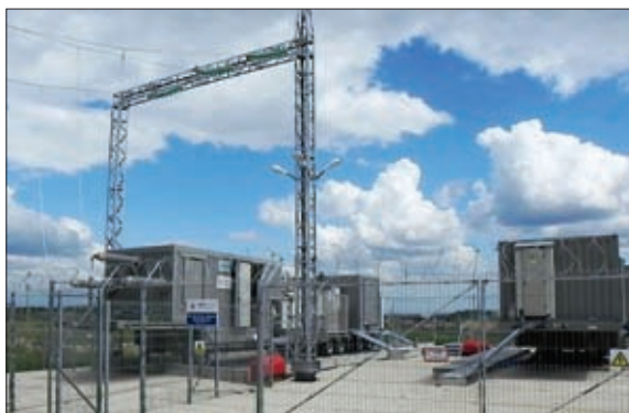
МОБИЛЬНАЯ ПОДСТАНЦИЯ «РОЖДЕСТВО»
