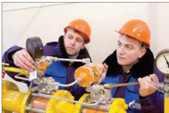
ТЕХНИЧЕСКОЕ ОБСЛУЖИВАНИЕ ГАЗОВОГО ОБОРУДОВАНИЯ ПУНКТА РЕДУЦИРОВАНИЯ ГАЗА
