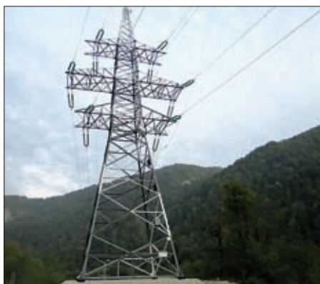
ОПОРА ЛЭП 110 КВ
