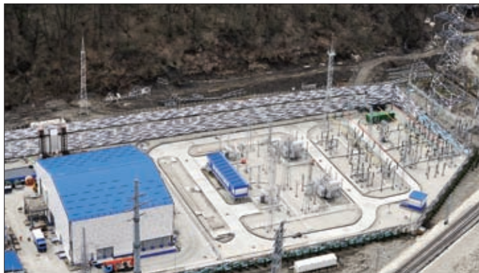
ПС 220 КВ «ПОСЕЛКОВАЯ»
