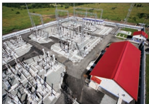
ПС 220 КВ «АЭРОПОРТ»
