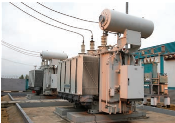
ПС 35–10 кВ «СЁЛКИ»
