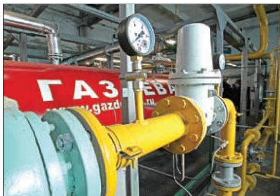
КОТЕЛЬНОЯ В КУЗНЕЦКОМ СЕЛЬСКОМ ПОСЕЛЕНИИ АРГАЯШСКОГО РАЙОНА ЧЕЛЯБИНСКОЙ ОБЛАСТИ, РЕКОНСТРУИРОВАННАЯ В 2011 ГОДУ
