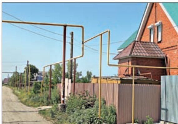
ГАЗОРАСПРЕДЕЛИТЕЛЬНЫЕ СЕТИ В ДЕР. КАСАРГИ СОСНОВСКОГО РАЙОНА
