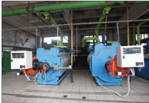
ОБОРУДОВАНИЕ МУНИЦИПАЛЬНЫХ КОТЕЛЬНЫХ
