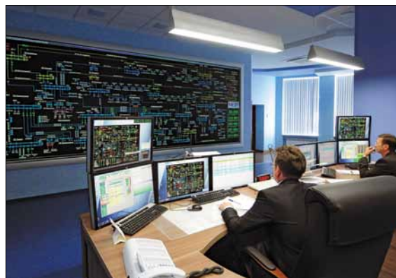
ОТСЮДА ВЕДЕТСЯ УПРАВЛЕНИЕ ЭНЕРГОСИСТЕМОЙ АСТРАХАНСКОЙ ОБЛАСТИ
