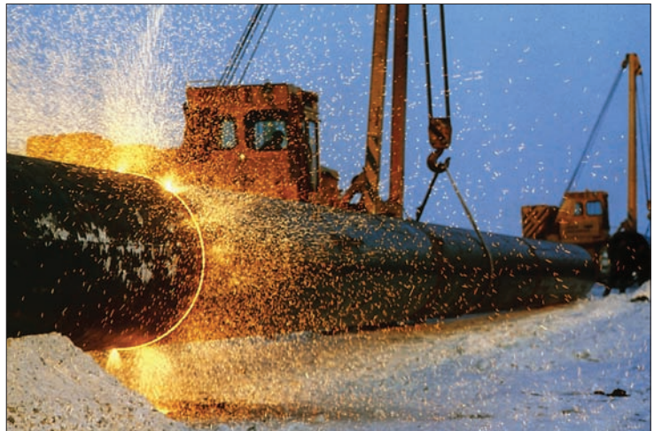
ЯМБУРГ – ЗАПАДНАЯ ГРАНИЦА СССР. АВТОМАТИЧЕСКИЙ СВАРОЧНЫЙ КОМПЛЕКС «СЕВЕР» НА СТРОИТЕЛЬСТВЕ ГАЗОПРОВОДА. ТЮМЕНСКАЯ ОБЛАСТЬ, 1988 ГОД
