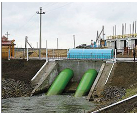
МАЛАЯ ГЭС НА ОЧИСТНЫХ СООРУЖЕНИЯХ
