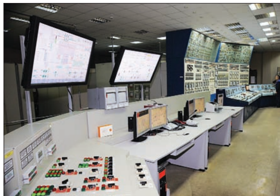
ОПЕРАТОРСКАЯ ХАБАРОВСКОЙ ТЭЦ-3
