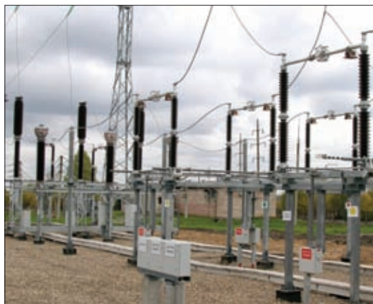
ПОДСТАНЦИЯ 220 КВ «МАНТУРОВО»
