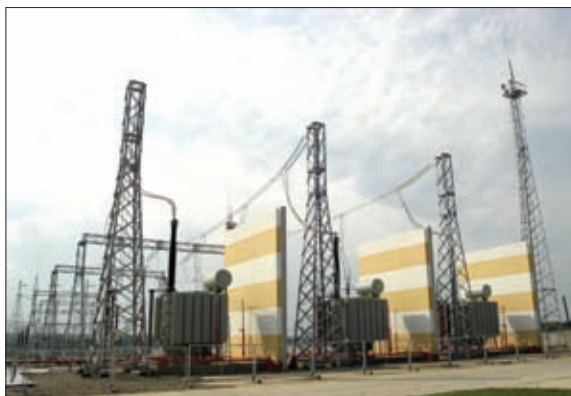
ПОДСТАНЦИЯ 500 КВ «ЗВЕЗДА»
