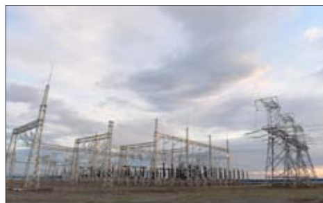
РАСПРЕДЕЛИТЕЛЬНЫЙ ПУНКТ 330 КВ «ГЕРАНБОЙ»
