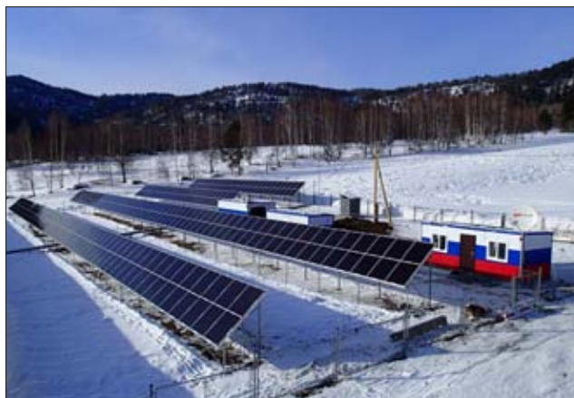
АВТОНОМНАЯ ГИБРИДНАЯ ЭНЕРГОУСТАНОВКА С. ЯЙЛЮ
