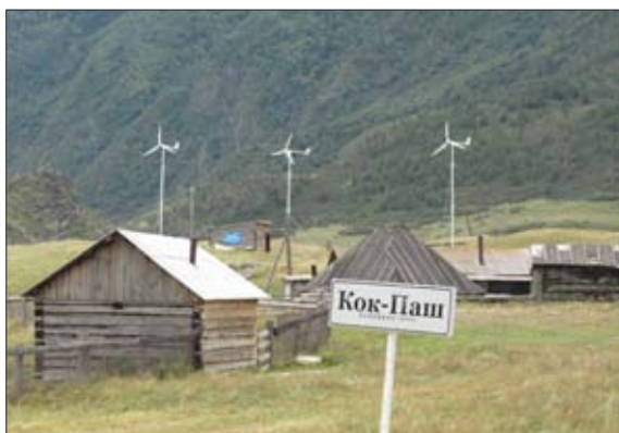
ВЕТРО-ДИЗЕЛЬ-ЭЛЕКТРОСТАНЦИЯ С. КОК-ПАШ
