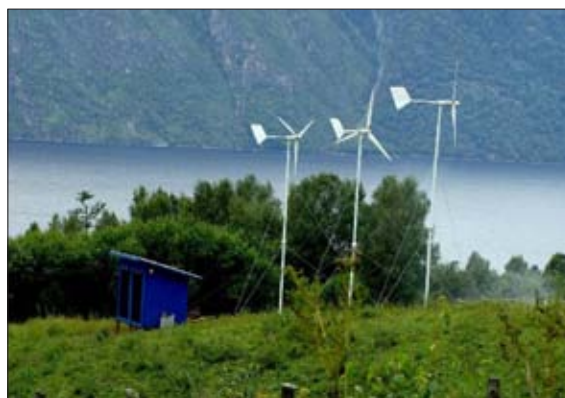
ВЕТРО-ДИЗЕЛЬ-ЭЛЕКТРОСТАНЦИЯ С. БЕЛЕ
