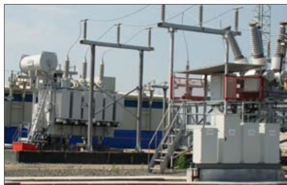
ЭНЕРГИИ ПОДСТАНЦИИ «КОЧКИНО» (ФИЛИАЛ ОАО «МРСК УРАЛА» – «ПЕРМЭНЕРГО») ХВАТИТ ДЛЯ ПРОИЗВОДСТВА ИННОВАЦИОННОГО КАБЕЛЯ, РАБОТЫ ТОРГОВЫХ И ЛОГИСТИЧЕСКИХ ЦЕНТРОВ, РАЗВИТИЯ ЖИЛИЩНОГО СТРОИТЕЛЬСТВА
