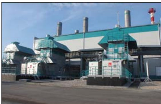
ЕЖЕГОДНО ЭЛЕКТРОСТАНЦИЯ ПРЕДПРИЯТИЯ «СИБУР-ХИМПРОМ» ВЫРАБАТЫВАЕТ БОЛЕЕ 150 МЛН КВТ ЭЛЕКТРОЭНЕРГИИ
