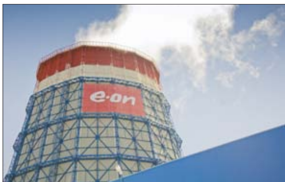
ЯЙВИНСКАЯ ГРЭС СНАБЖАЕТ ЭЛЕКТРОЭНЕРГИЕЙ ПРЕДПРИЯТИЯ И НАСЕЛЕННЫЕ ПУНКТЫ ВЕРХНЕКАМЬЯ, В ТОМ ЧИСЛЕ МОЩНЫЙ БЕРЕЗНИКОВСКО-СОЛИКАМСКИЙ ПРОМЫШЛЕННЫЙ УЗЕЛ
