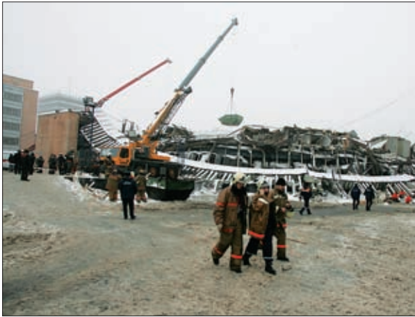
УЧАСТИЕ В ЛИКВИДАЦИИ ПОСЛЕДСТВИЙ ОБРУШЕНИЯ КРЫШИ БАСМАННОГО РЫНКА В МОСКВЕ, МАРТ 2006 ГОДА
