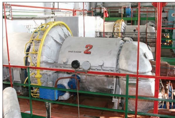
ДОЖИМНАЯ КОМПРЕССОРНАЯ СТАНЦИЯ НА МЕДВЕЖЬЕМ МЕСТОРОЖДЕНИИ
