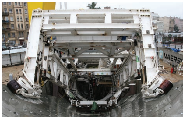
СООРУЖЕНИЕ НАКЛОННОГО ХОДА СТАНЦИИ МЕТРОПОЛИТЕНА С ПОМОЩЬЮ ТПМК ФИРМЫ «ХЕРРЕНКНЕХТ» В САНКТ-ПЕТЕРБУРГЕ
